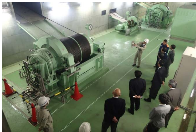
ダム内部のゲート設備を見学
