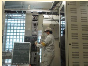
電気設備の点検状況
