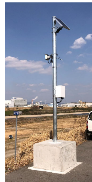
簡易型河川監視カメラ
