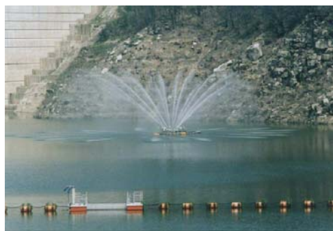
●小里川表層循環設備
