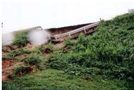
写真 2.1.6 堤防の不安定化、損傷
