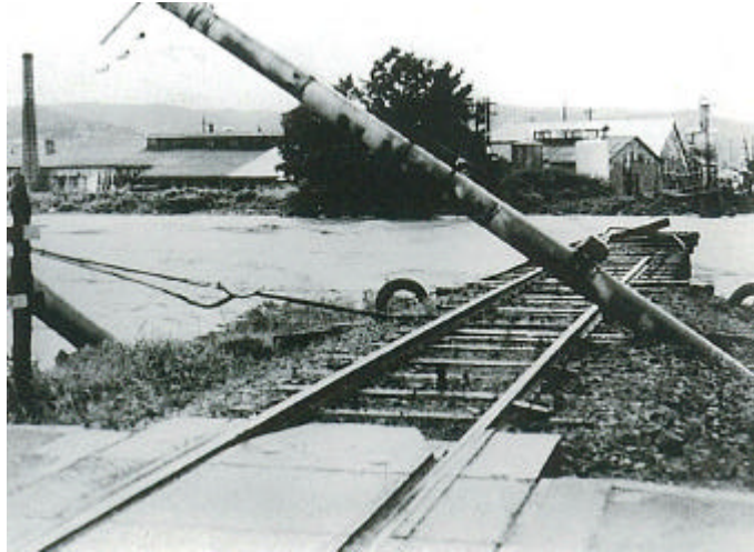
図-4.5 土岐市新土岐津西町付近(昭和47年7月洪水)
