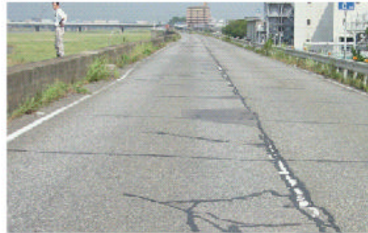
図-7.18 クラックが入った状況
