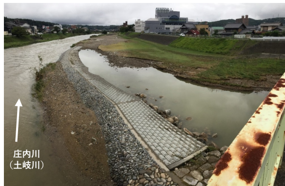
土岐津橋下流 (被災後)
