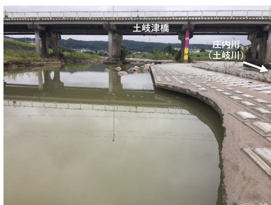
土岐津橋下流（被災後）
