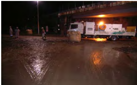
<H23 台風 15 号災害で排水ポンプ車を運営>
