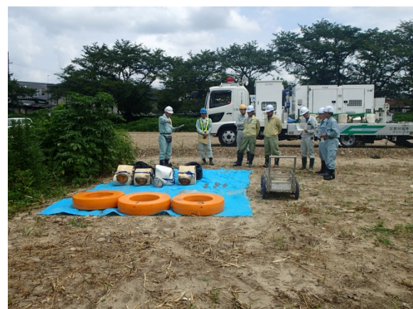
写真④:排水ポンプ車概要説明
