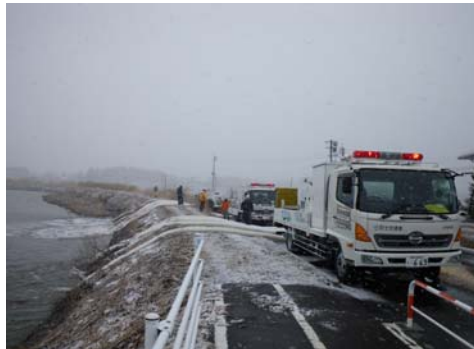
東日本大震災で排水中の排水ポンプ車
