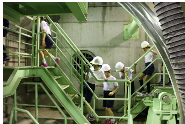
ヘルメットを被ってゲート室の内部へ
