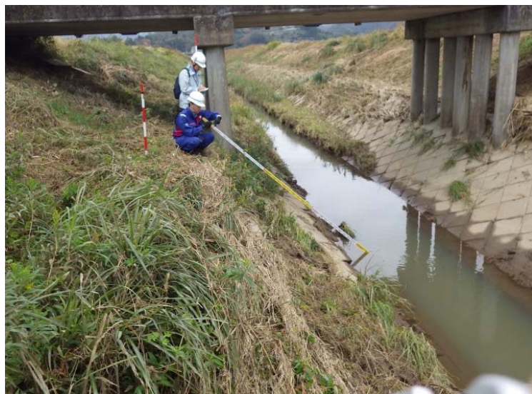
被災箇所調査状況 （清水川 25日降雨後の再調査）
