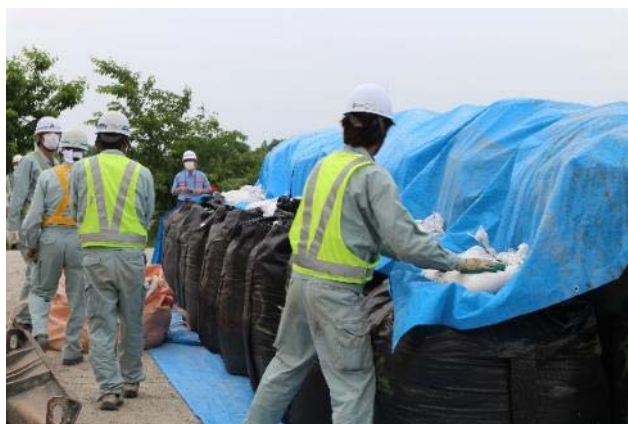
ブルーシートの押さえと端部の調整として小口土のう72個を設置
