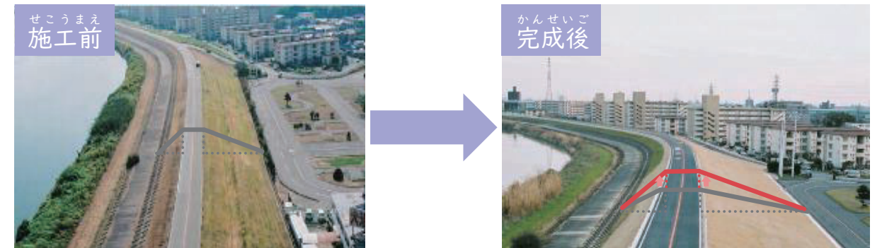
堤防の工事 (堤防の高さや幅が不足していた箇所を整備)
