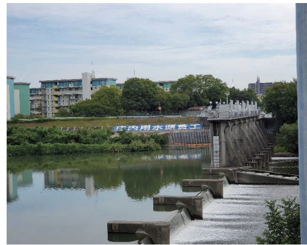
しょうないようすいとうしゅこう なごやし 庄内用水頭首工(名古屋市)
