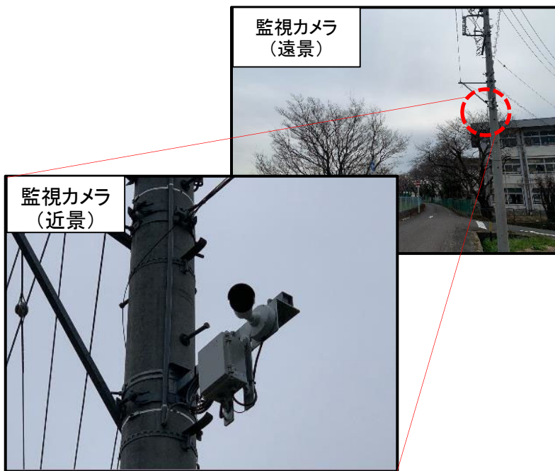
監視カメラの設置・増設(稲沢市)
