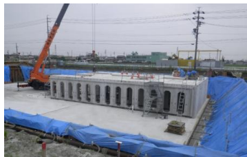
雨水貯留施設の整備 （北名古屋市）
