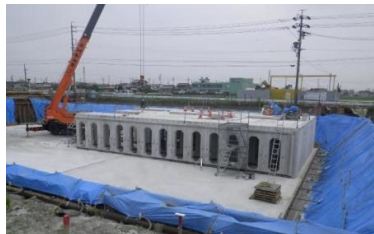
雨水貯留施設の整備 (北名古屋市)
