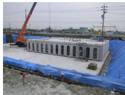
雨水貯留施設の整備 (北名古屋市)
