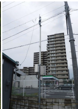
河川カメラの設置状況
