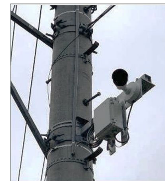
監視カメラの設置状況
