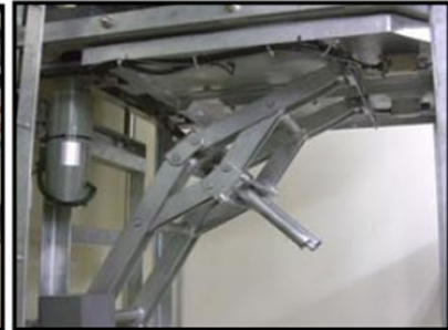
換気口浸水防止機
