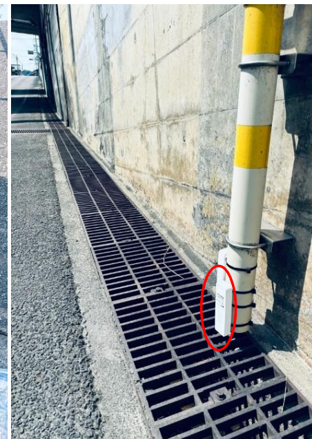
冠水が発生しやすい市道
