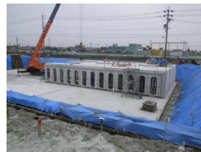
雨水貯留施設の整備 (北名古屋市)
