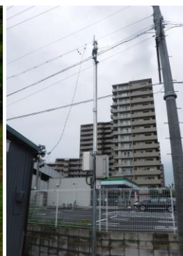
河川カメラの設置状況
