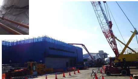
広川ポンプ所
