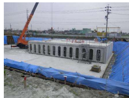
雨水貯留施設の整備 (北名古屋市)
