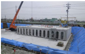
雨水貯留施設の整備 （北名古屋市）
