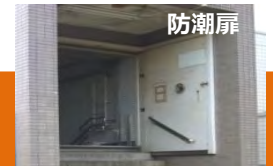
地下鉄出入口の浸水対策
