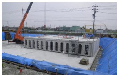
雨水貯留施設の整備 (北名古屋市)
