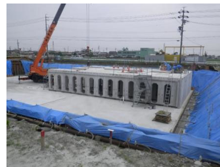
雨水貯留施設の整備 (北名古屋市)
