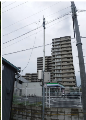
河川カメラの設置状況
