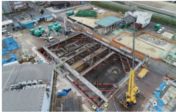
地蔵川排水機場の整備状況（愛知県）
