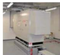
非常用発電設備のイメージ
