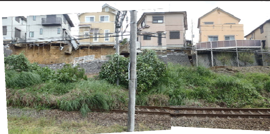
平成29年台風21号の影響で宅地擁壁が崩壊
