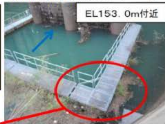
発電取水用除塵フロート
