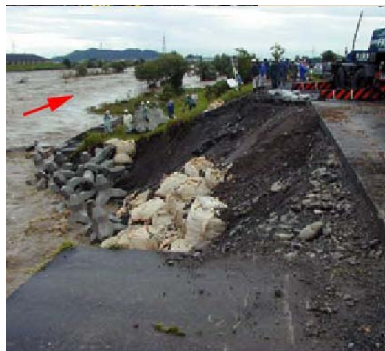
堤防の一部損傷
