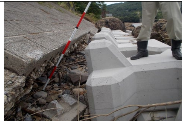
護岸背面の土砂が吸出し(深さ90cm)
