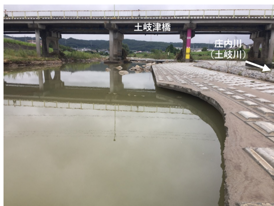
土岐津橋下流（被災後）
