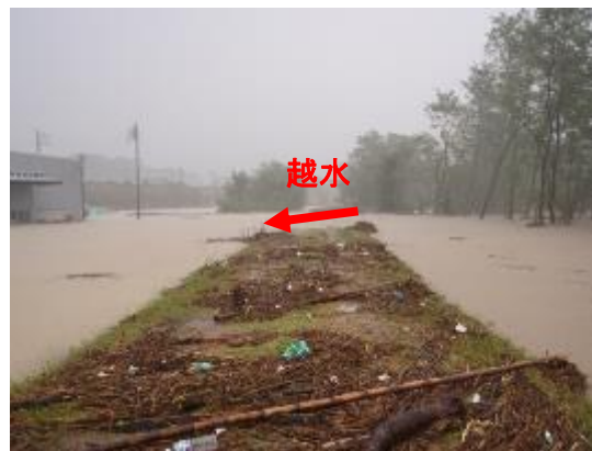
①堤防越水状況
