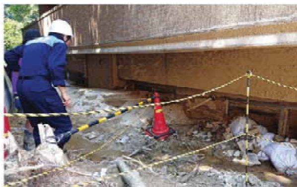
土石流災害により1階部分が壊れた家屋 平成30年7月豪雨災害（広島県海田町） 写真提供：広島県海田町
