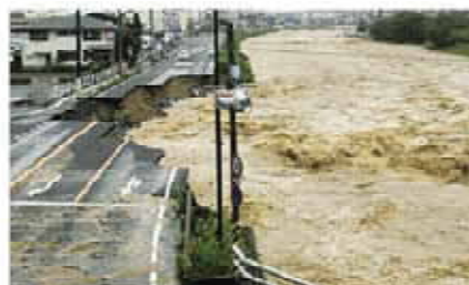
洪水による道路閉鎖 平成30年7月豪雨災害(岐阜県岐阜市) 写真提供:国土交通省中国地方整備局
