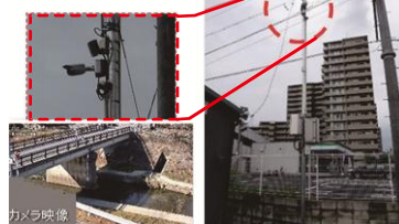
監視カメラの設置・増設（長久手市）
