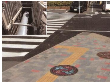
雨水排水網の新設・増強雨水排水路（多治見市）
