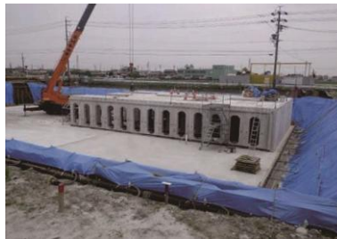
雨水貯留施設の整備（北名古屋市）
