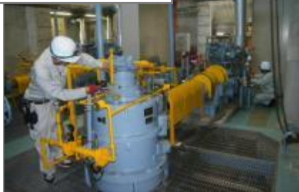
ポンプ設備の点検
