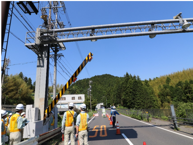
操作盤（電動）による遮断機の降下
