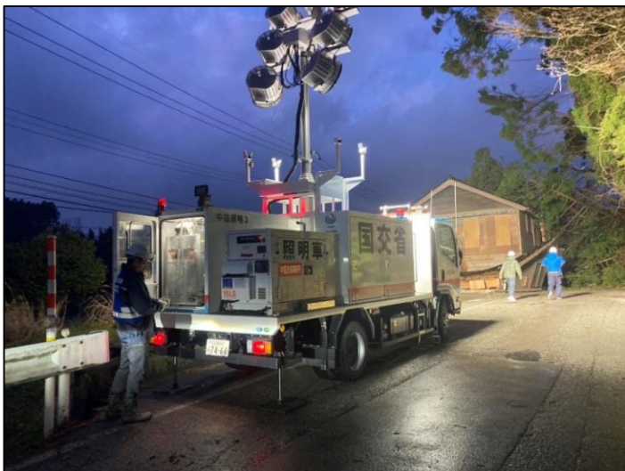
4工区(輪島市里町)で活動する照明車(1/6)
