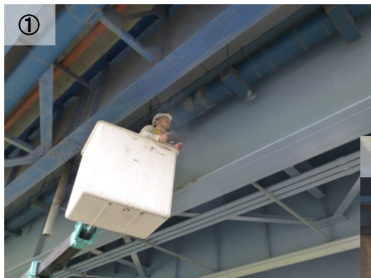
①高所作業車による近接目視 国道1号駿河大橋 桁の腐食・損傷箇所の有無を確認
