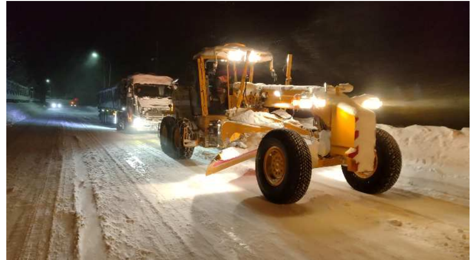
(令和6年2月 国道17号 群馬県みなかみ町)
