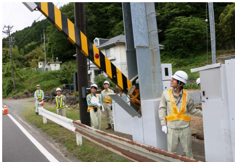
通行止めの際、遮断機を操作できるよう、 機側盤（電動）で遮断機を操作
