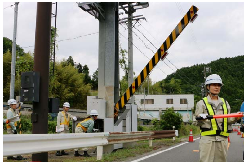
停電が発生し電動で操作できないことも想定して、 手動で遮断機を操作
