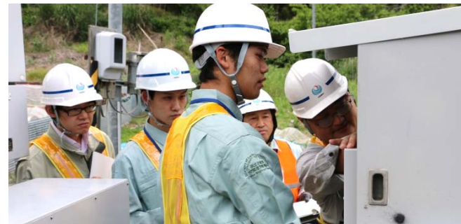
通行止めの際、遮断機を操作できるよう、機側盤（電動）で遮断機を操作。
