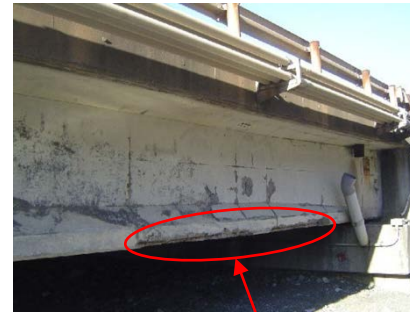
旧橋の損傷状況: コンクリートの剥離
