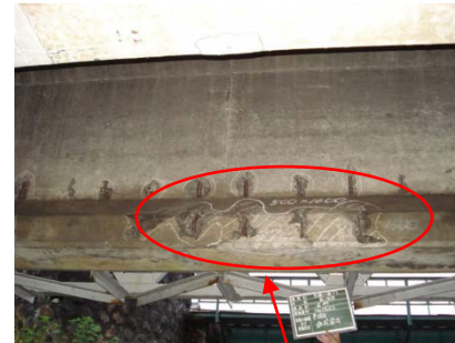
旧橋の損傷状況: 鉄筋の露出
