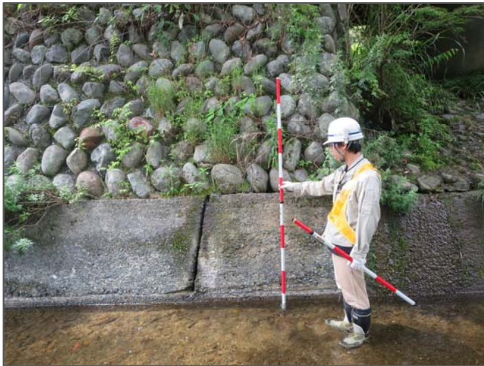
①擁壁変状確認
