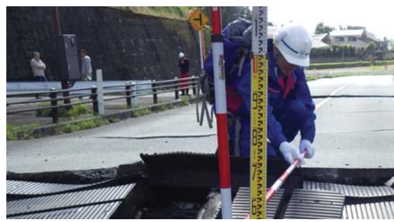
大切畑大橋被災状況調査その2
