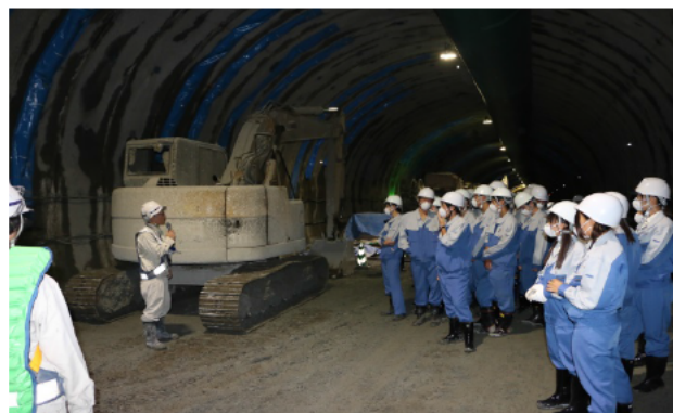
★トンネル掘削に使われる重機の使い方や、 その特徴を学びました。
