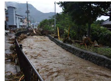
河川被害状況 安良里地区浜川
